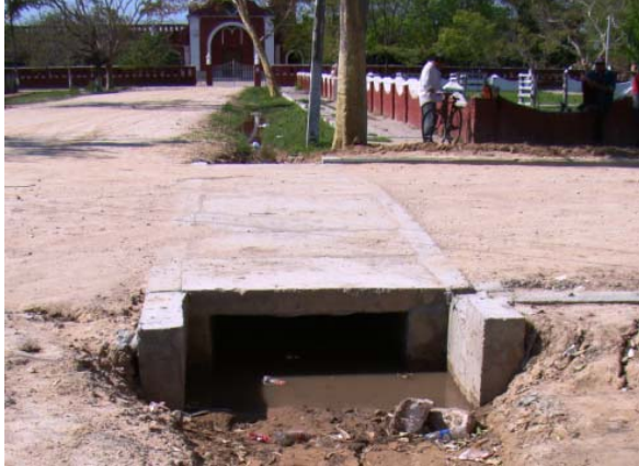
Aguas servidas expuestas en la población de Puerto Casado.
